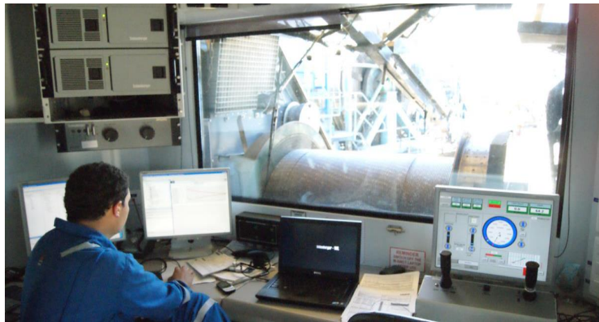
Figura 6. Cabina unidad de línea eléctrica
