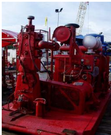
Figura 17: Compresor Booster de alta presión
