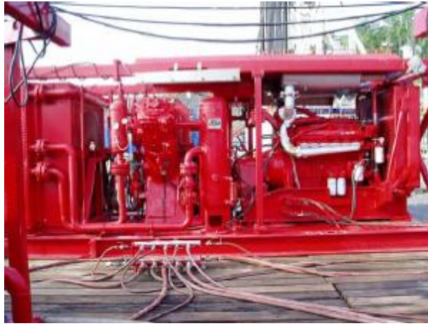
Figura 16: Compresor Booster de baja presión
