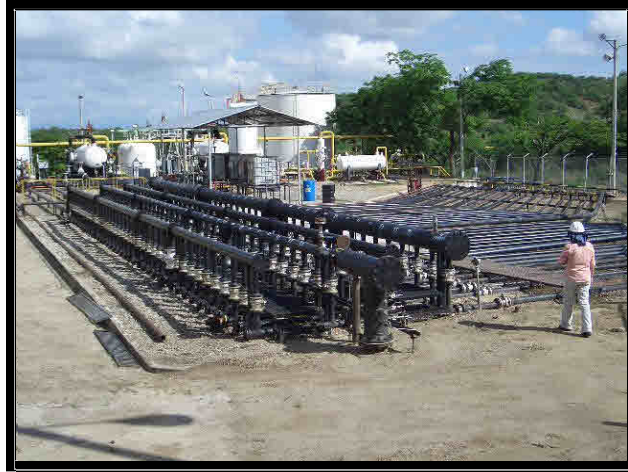
Figura 23: Manifold de la Batería
