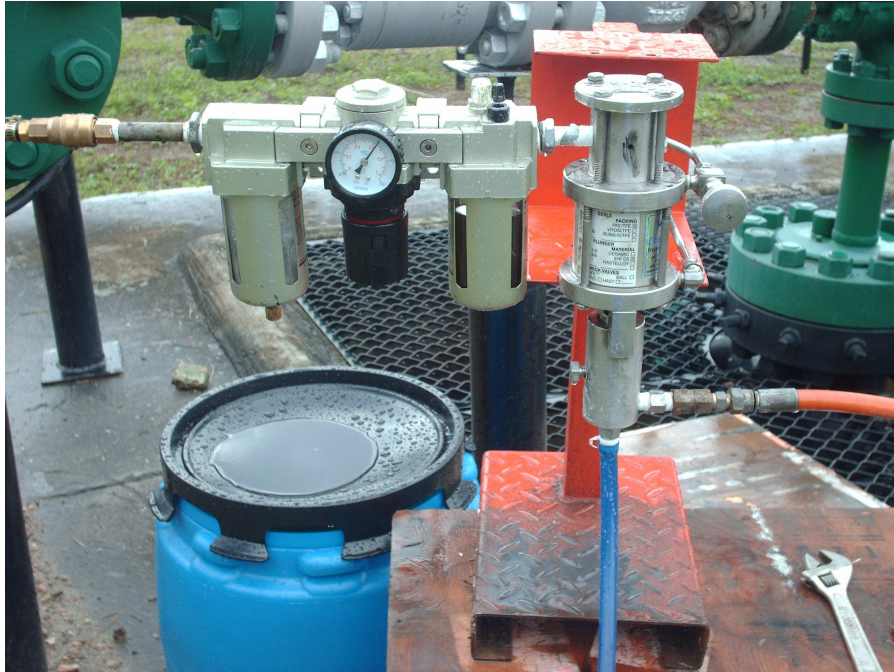
Figura 19. Inyección en marcha.
