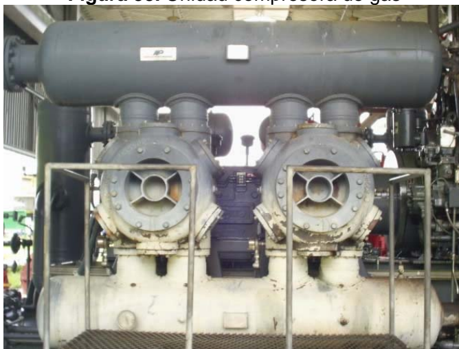
Figura 33. Unidad compresora de gas
