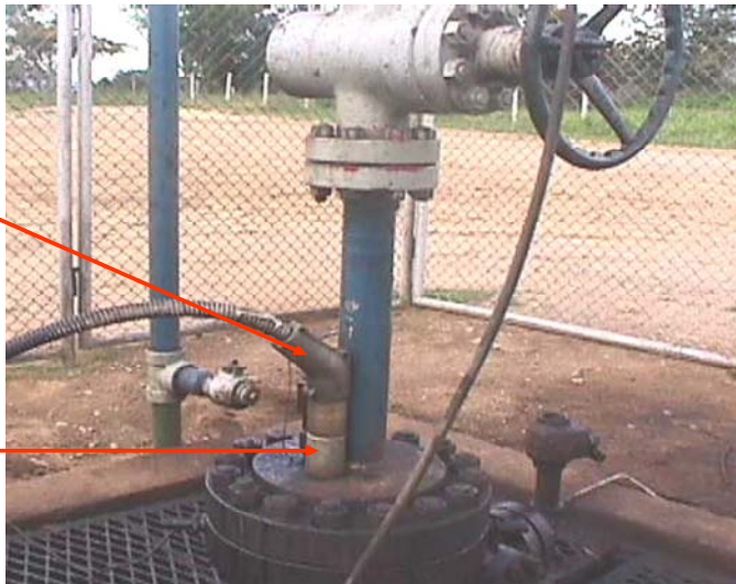
Figura 64. Cabezal de pozo.
