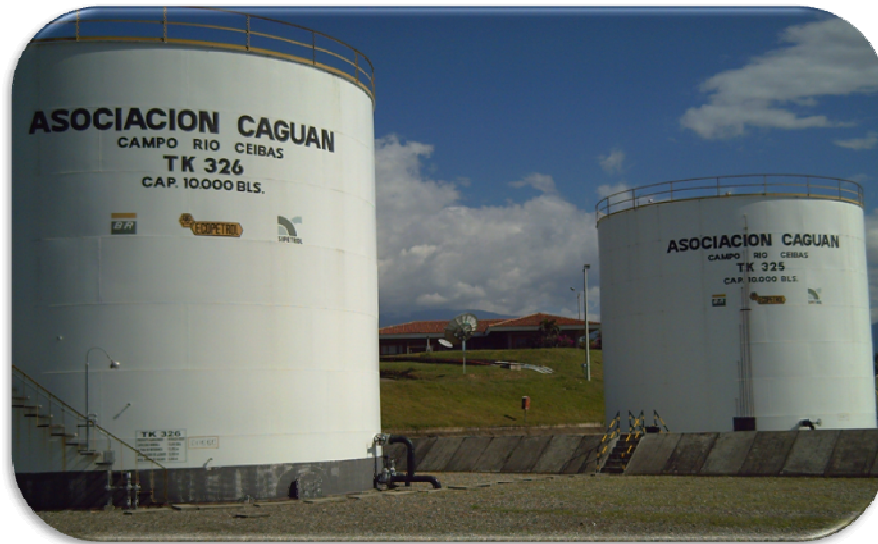
Figura 8. Tanques de Almacenamiento, 10000 BLS.
