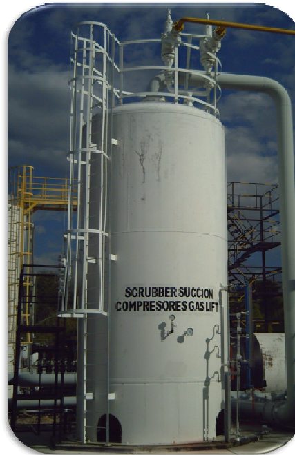
Figura 11. Scrubber Salida Separadores y Succión Compresores Gas Lift
