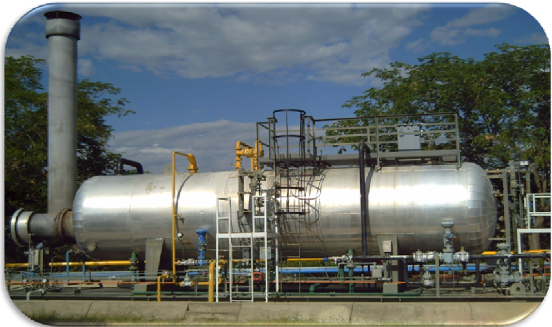
Figura 7. Calentador Estación Río Ceibas
