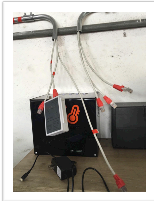
Figura 47. Probador de cable UTP y llegada a caja principal.
