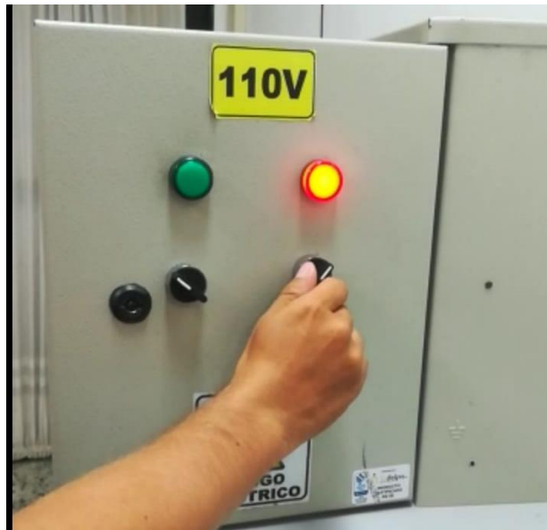
Figura 26 Modo Manual-- Fuente Sistema fotovoltaico
