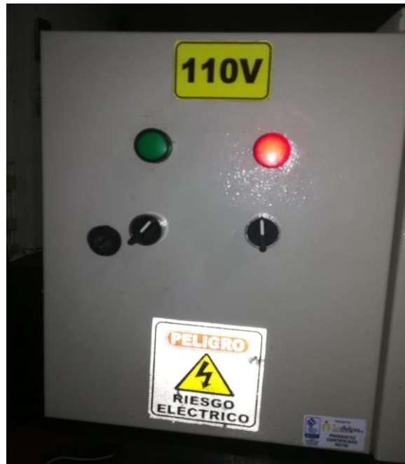
Figura 17. Foto tablero de control gabinete
