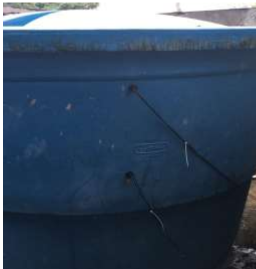
Figura 31. Tanque y Sensores de Nivel.
